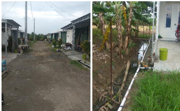
Gambar 4 Contoh Kondisi Prasarana Dasar yang Kurang Baik
