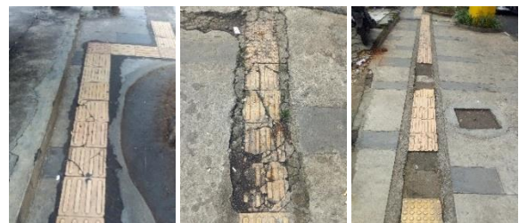
Gambar 15 Kerusakan pada Ubin Jalur Pemandu (Kiri-Kanan: Ringan, Berat dan Hilang/Terlepas)
