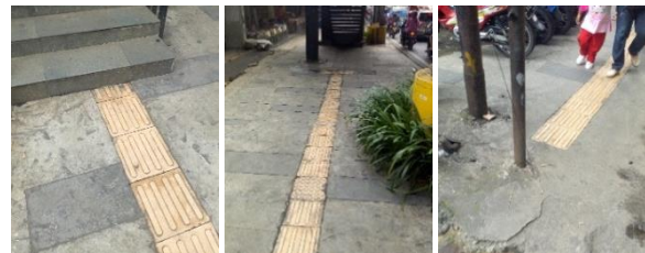
Gambar 14 Kesalahan Pemasangan Tekstur Ubin Pemandu
