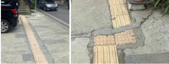
Gambar 16 Kondisi Jalur Pemandu yang Tertutup Semen
