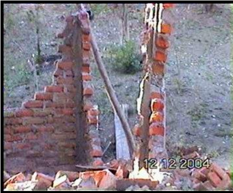
Gambar 3. Rumah Tinggal dengan Struktur Sambungan Kolom, Balok dan Pasangan Bata Tidak Sempurna.
