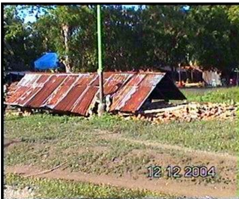
Gambar 4. Rumah Tinggal Runtuh Total Tinggal Penutup Atap Seng.
